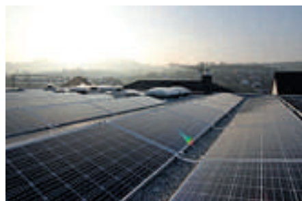
Die auf dem Flachdach des Bürotraktes montierte Photovoltaik-Anlage versorgt das Unternehmen mit eigenem Strom.
