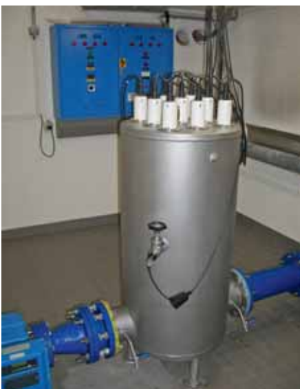
Nach den Grundwasserpumpen ist eine moderne UV-Aufbereitungsanlage in das System eingeschaltet. 9 UV Lampen töten notfalls vorhandene Colibakterien.
