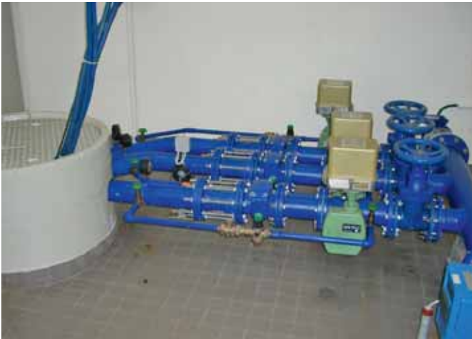
3 Pumpen mit je 1300 l/min Leistung fördern das Grundwasser aus dem Pumpschacht in die Druckleitung mit 7 bis 10 bar.
