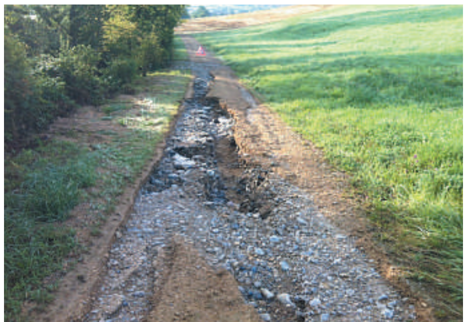
Derartige Flurwegschäden können mit einer guten Entwässerung zum grossen Teil verhindert werden.
