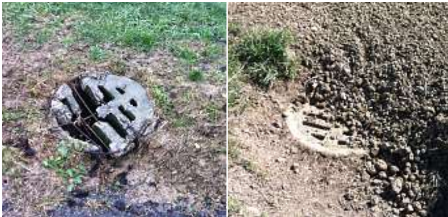
Durch defekte Schachtdeckel verstopfen Schächte und Drainagen und verhindern schliesslich die Ableitung des Oberflächenwassers. Die Verursacher müssen den Schaden an das Bauamt melden, damit die Abdeckung ersetzt werden kann.
